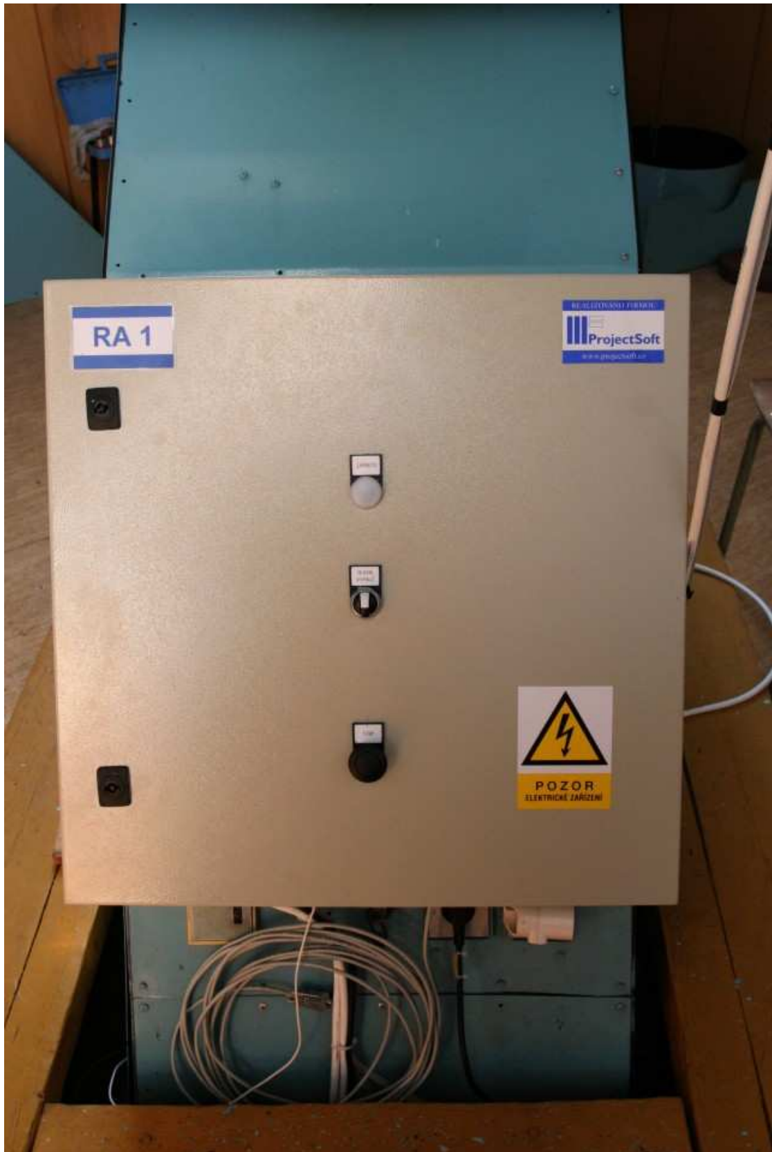
Elektronická část řídicí jednotky velké kopule. Podobná, byť větší, řídí i největší český dalekohled – ondřejovský dvoumetr. Řídicí jednotku realizovala firma ProjectSoft z Hradce Králové. Marcel Bělik
